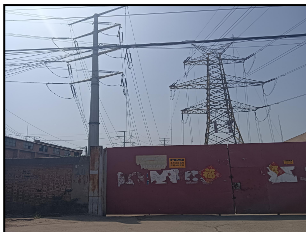
项目西侧陡沟变电站
